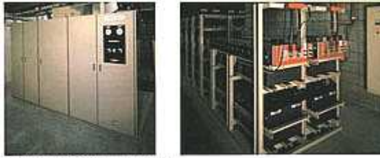
รูปที่ 12 ระบบไฟฟ้าสำรอง และ UPS
