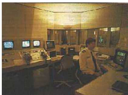
รูปที่ 7 ตัวอย่างห้องควบคุมอาคารกลาง
